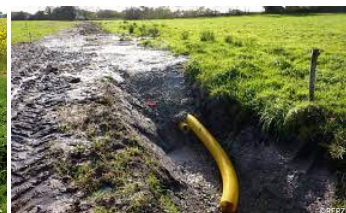
Drain enterré dans une prairie humide
